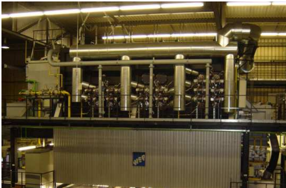
Bild 9: Durchhangglühofen zur Wärmebehandlung von Bändern aus Cu-Legierungen unter Schutzgas mit 100% H 2
