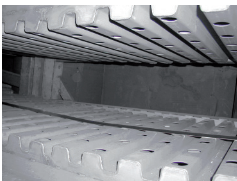
Bild 4: Düsenystem in einem Durchhangofen für Cu-Band und höhere Temperaturen. Man erkennt das zur Düsenfeldmitte hin verschobene Einzugsband.
